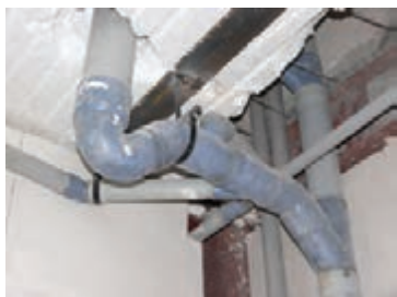
▲ شکل ۲-۴۷ به کارگیری لوله PVC در لوله کشی فاضلاب
