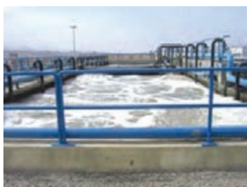
▲ شکل ۸-۲ تصفیه خانه آب
