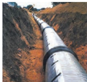
▲ شکل ۲-۲۲ لوله کشی انتقال آب شهری
