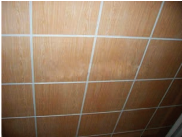
► شکل ۱-۶۱ سقف کاذب تایل پی‌وی‌سی با شبکه فلزی
